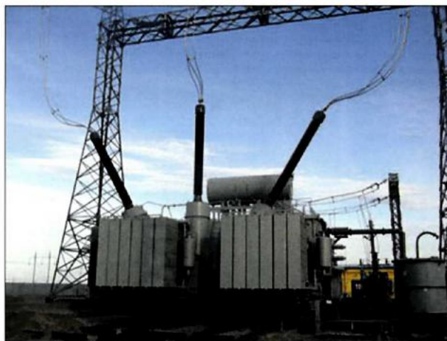
Рис. 5. УШР типа РТУ-180000/500 в трёхфазном исполнении на ПС Агадырь (2009 г.)
