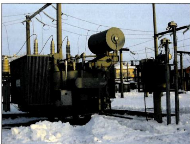
Рис. 1. Шунтирующий реактор, управляемый подмагничиванием, типа РТУ-25000/110 на подстанции Кудымкар “Пермэнерго” (включён в эксплуатацию в сентябре 1999 г.)
